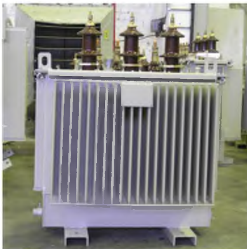
Рис. 1.1 Трансформатор герметичный без расширителя ТНГ
