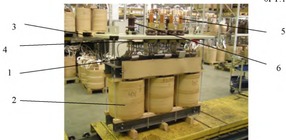
Рис. 2.1 Активная часть в сборе. 1 – магнитопровод; 2 – блок обмоток ВН – НН; 3 – крышка бака; 4 – переключатель; 5 – ввод НН; 6 – ввод ВН.
